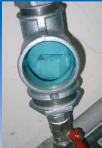
Schaumstoffkörper (Molch) in der Molchauffangvorrichtung.
