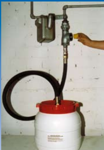
Molchauffangvorrichtung und Ausblasebehälter.
