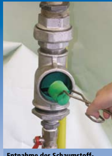
Entnahme des Schaumstoffkörpers (Molch) aus der Molchauffangvorrichtung.
